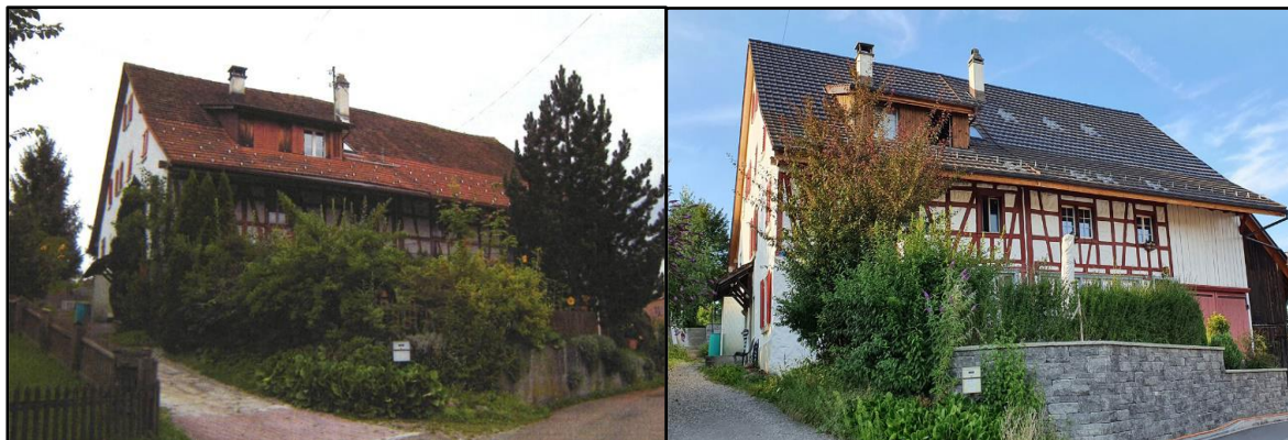
Slika 27: Streha pred sanacijo in po sanaciji pokrita s solarno opeko, Zürich. (Vir: Eitner, 2021).
